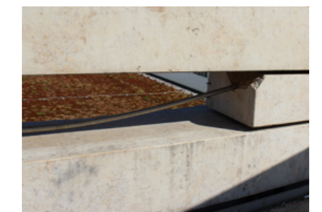
Abbildung 14 ▼ Zerstörtes Zwischenelement aus Metall an einer Brüstung des Neuen Döppersbergs
